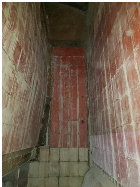
Changement de la trémie d'alimentation Ligne 2 en trémie sèche au lieu d'un water-jacket.
